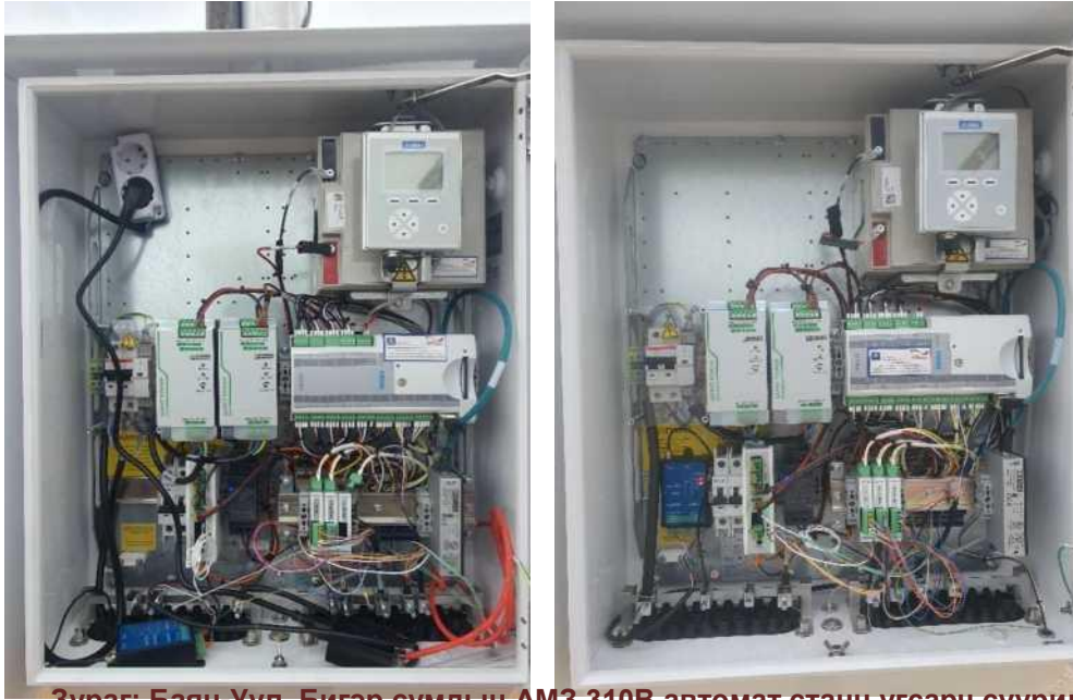
Зураг: Баян-Уул, Бигэр сумдын АМ3 310В автомат станц угсарч суурилуулсаны дараах байдал
